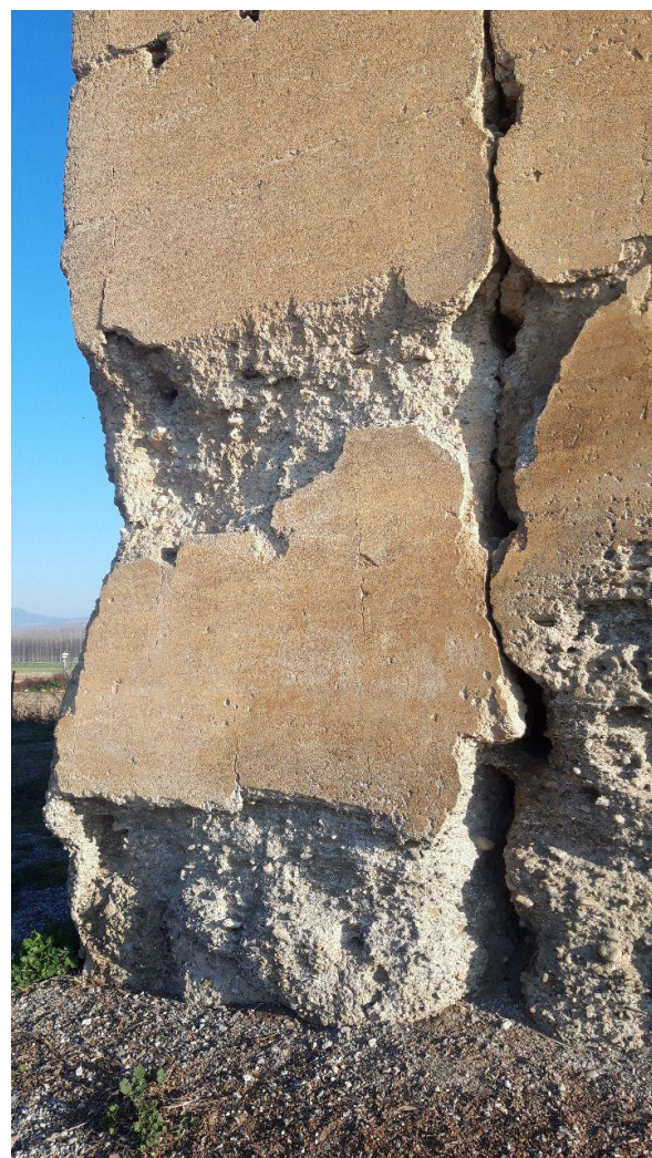
Fig. 6. Desperfectos visibles en el actual estado de la torre. Fuente: Elaboración propia.
