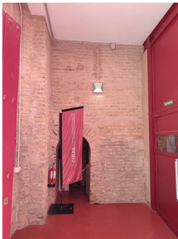
Fig. 8. Vista interior del lugar que debió ocupar la capilla y que actualmente corresponde con los restos de la torre. Fotografía: Autor.
