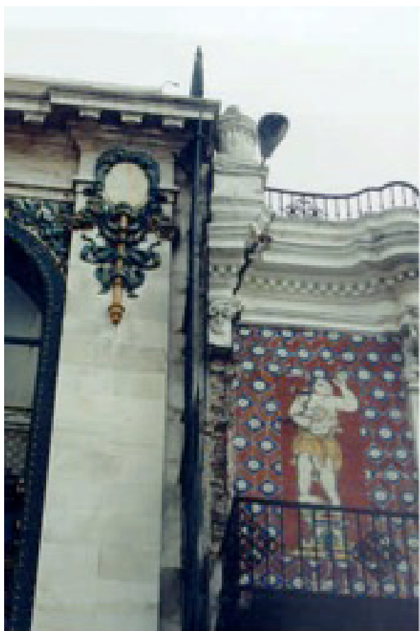
Fig. 1. Fachada del Museo casa de lo Muñecos. 1999. Puebla. México. (CENAPRED). Detalle frontal del daño ocasionado en la Fachada del Museo Casa de los Muñecos de la BUAP, después del temblor del 15 de junio de 1999. La imagen muestra su muro compartido con el edificio de la Fundación Jenkins, hoy Capilla del Arte de la UDLAP.
