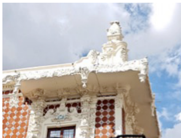
Fig. 4. Detalle de los desperfectos en el pináculo de la fachada. 2017. Puebla, México. (PueblaDos22.). Daños registrados en la esquina del inmueble y que afectan los elementos ornamentales del exterior.
