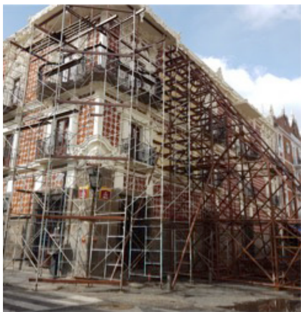
Fig. 3. Fachada del Museo Casa de Alfeñique después del sismo. 2017. Puebla, México. (Isabel Fraile). Apuntalamiento del Museo Casa de Alfeñique con andamios y acero días después de temblor.
