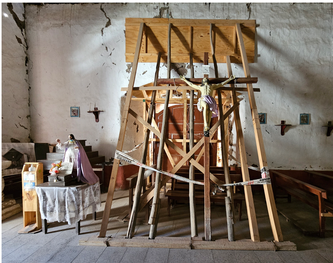
Fig. 7. Detalle del apuntalamiento de emergencia del templo de San Martín de Tours de Codpa. Fotografía: Autoras.
