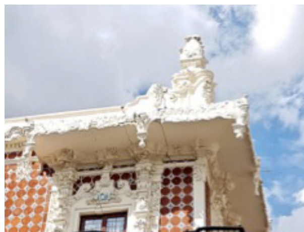
Fig. 4. Detalle de los desperfectos en el pináculo de la fachada. 2017. Puebla, México. (PueblaDos22.). Daños registrados en la esquina del inmueble y que afectan los elementos ornamentales del exterior.
