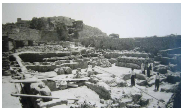
Fig. 3. Obras de restauración de la Alcazaba. Archivo Histórico Provincial de Málaga. Archivo personal González Edo. 14.022.
