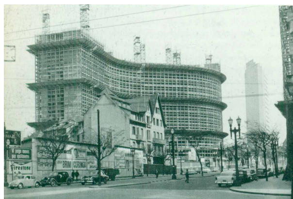
Fig. 1. Oscar Niemeyer. Edificio COPAN. São Paulo. Fotografía del exterior en construcción. h. 1952.
