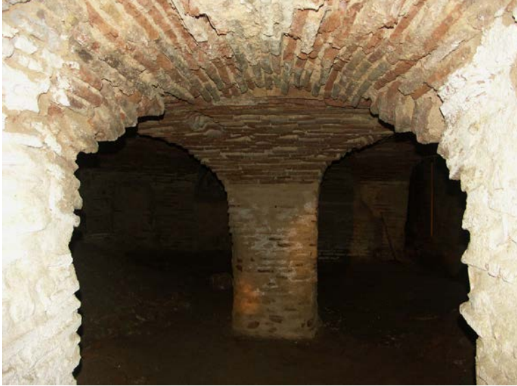
Figura 9. Callejón de Samuel Levi, s/n: pilar central en el sótano bajo la sala de exposición
