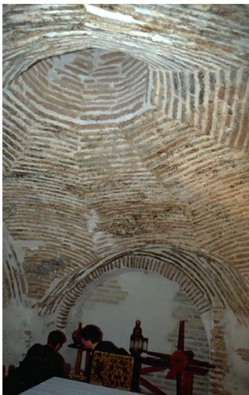
Figura 4. Plaza del Cerro de la Virgen de Gracia n° 8: sótano con occulus cenital
