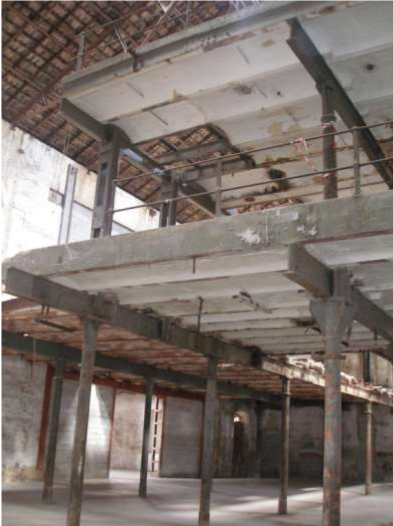
Ilustración 09. Estado actual (2008) del forjado de la Fábrica de San Isidro. Fuente: Elaboración propia.
