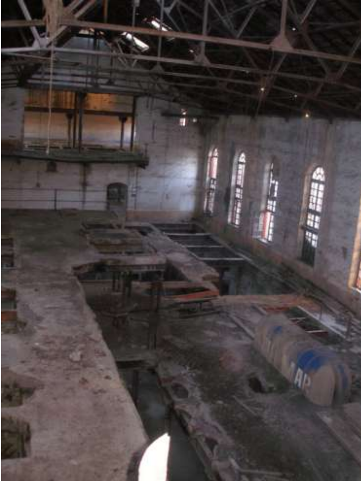
Ilustración 05. Estado actual (2008) del forjado de la Fábrica de San Isidro. Fuente: Elaboración propia.
