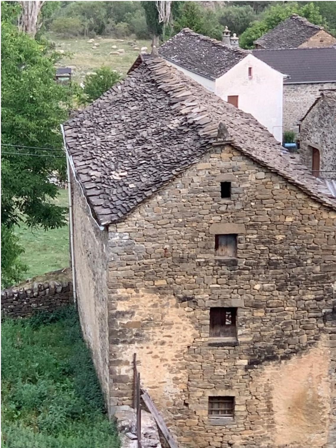
Ilustración 5. Tejados de losa. Linás de Broto (Huesca). Arquitectura popular pirenaica. La pérdida del oficio y los conocimientos tradicionales es una de las causas de su sustitución por tejado de teja, pizarra o uralita. Elaboración propia.
