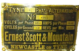
Imagen 16: Placa de características del generador. Fotografía del autor.
