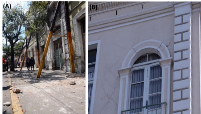
Figura 2. Daños a la infraestructura provocados por el terremoto del 19 de septiembre del 2017. A: Edificio con daños severos en el centro de la Ciudad de Toluca. B: Detalle de una de las torres del edificio de Rectoría de la Universidad Autónoma del Estado de México.
