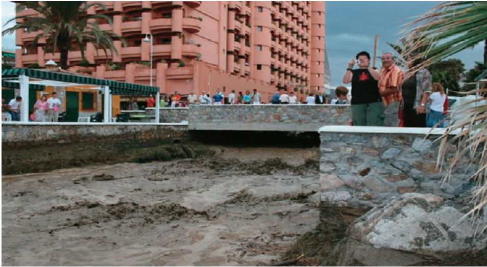
Foto 4. 21/09/07. Desembocadura del río Seco. En el muro de la izquierda, desplomado poco después, se observa la marca de la altura alcanzada por el agua
