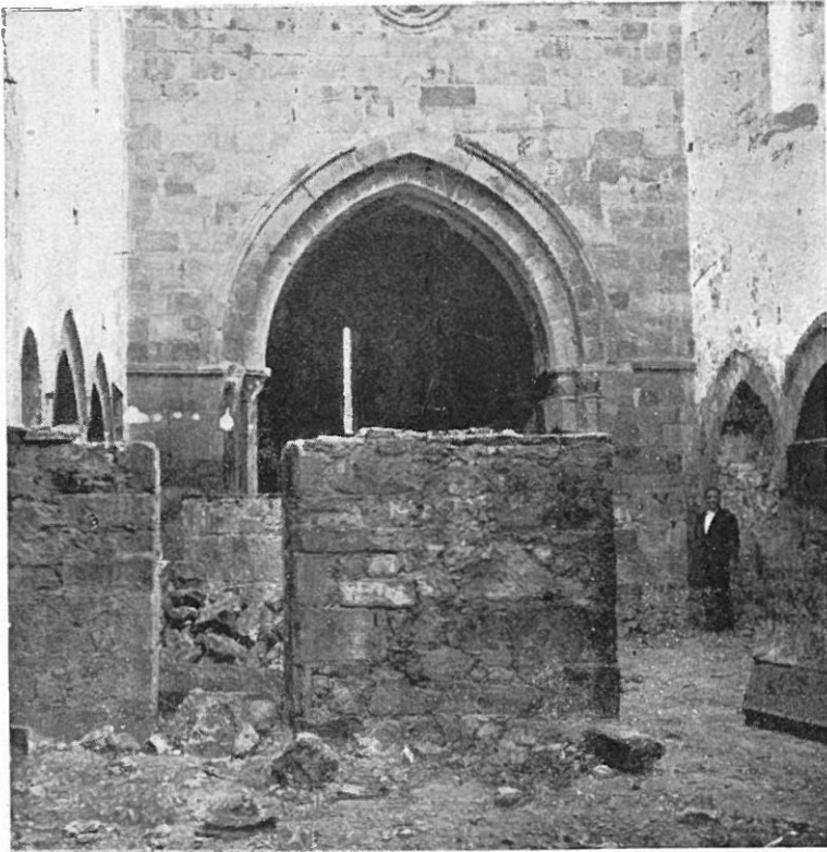
VILLAVICIOSA (ASTURIAS).—INTERIOR DE LA IGLESIA DE SANTA MARÍA EN SU ESTADO ACTUAL. DESTRUÍDA POR INCENDIO.
